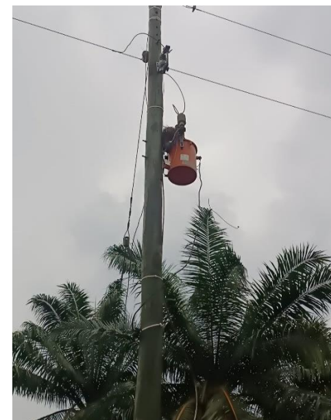
Fotografía No.3: Registro de transformador existente (Tomada de archivo particular).
