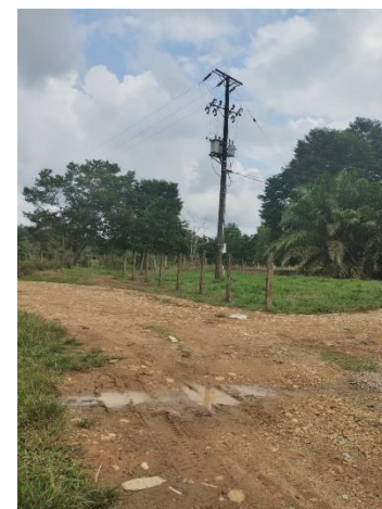
Fotografía No.3: Registro de localización transformador existente (Tomada de archivo particular).
